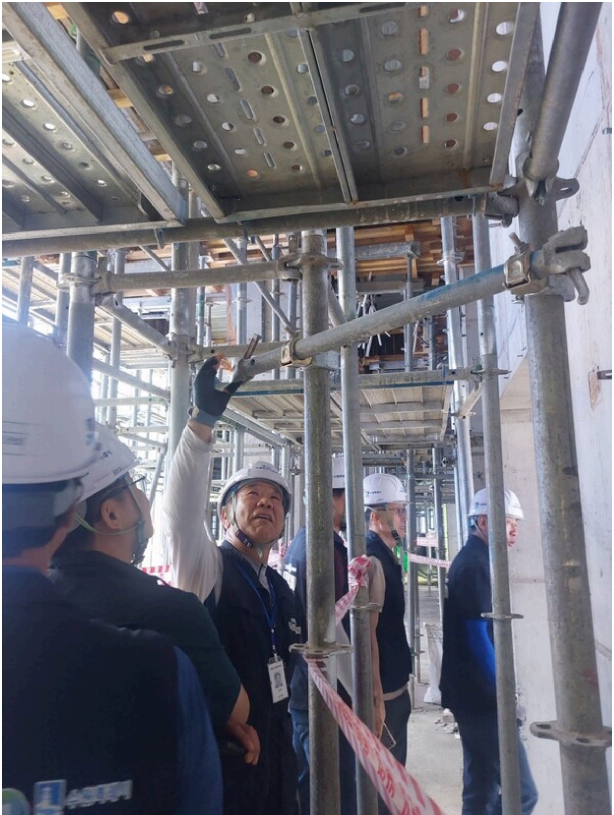
의왕시와 수원시 관계자, 노동안전지킴이 등 18명은 6월10일 부곡센터 현장을 찾아 추락 방지 시설과 작업자 안전수칙 준수 여부를 확인했다. (사진=의왕시)
